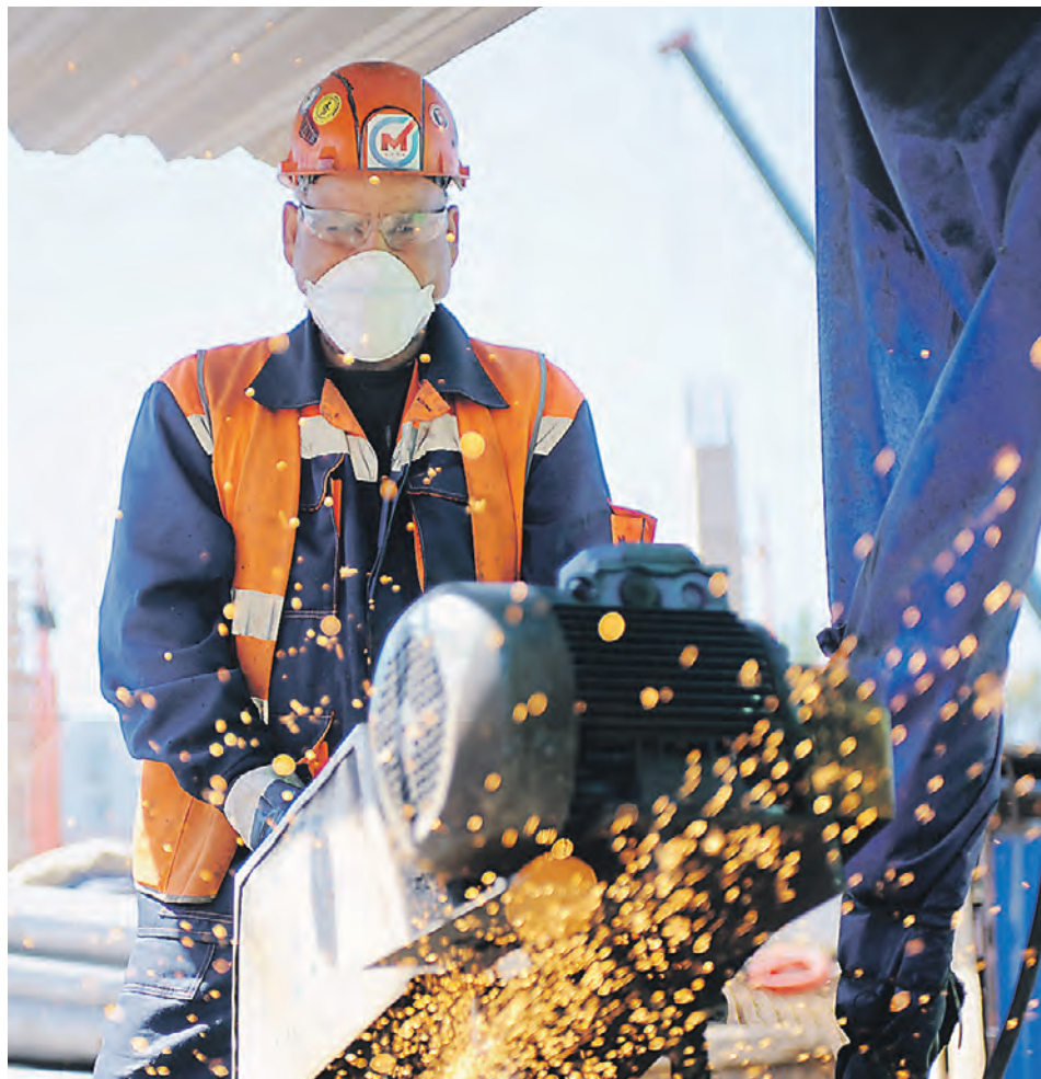
2 июля 2022 года. Работы у станции БКЛ «Печатники». Сварщик Аббсама Назаров обрабатывает арматуру, чтобы связать металлические прутья в решетку
