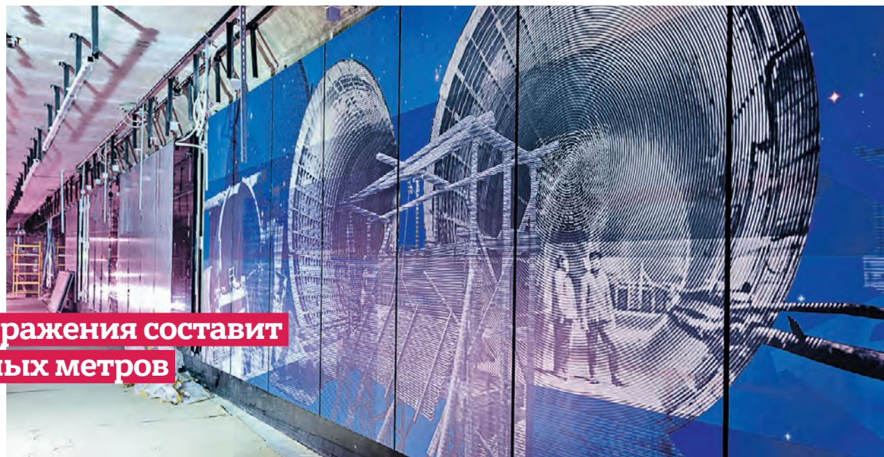
11 ноября 2021 года. Слесарь Сергей Сняков проводит работы на станции БКЛ «Сокольники» (1). Будущее оформление станции БКЛ «Сокольники» (2)
