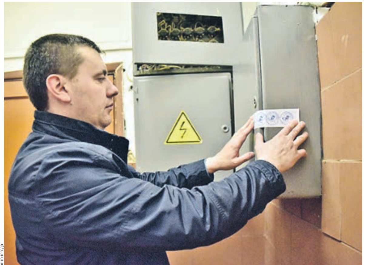
Вчера 18:20 Главный инженер участка № 9 Роман Власков демонстрирует штипки: они опечатаны, а электричество во всем доме, где расположена «Управляющая компания Пресненского района», исправно работает
