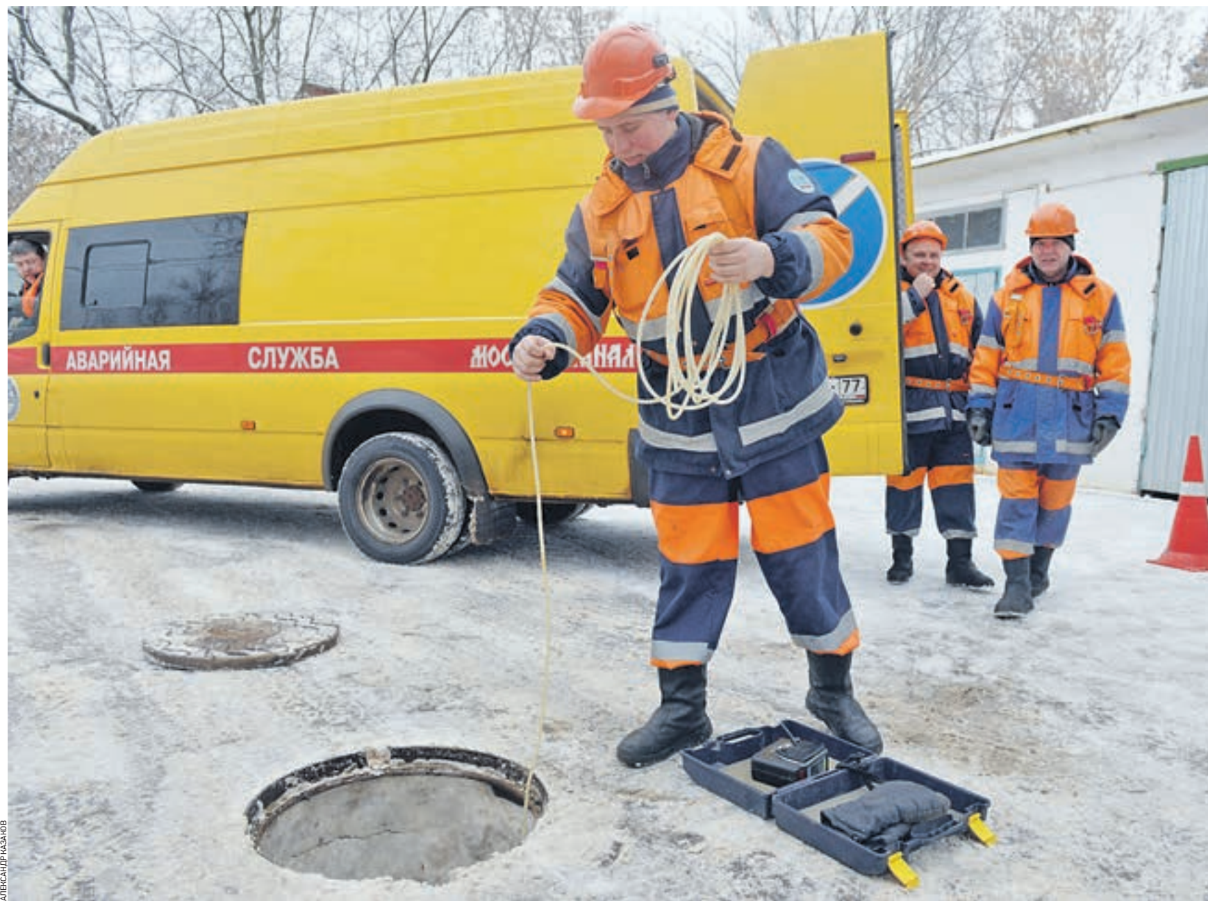
5 февраля 2015 года, Волоколамское шоссе. Слесарь Павел Пароль с помощью газоанализатора проверяет, есть ли в канализационном колодце опасная концентрация газа. Как выяснилось, концентрация безопасна, а значит, на объекте можно вести работу, не опасаясь взрыва. Каждый слесарь обязан уметь пользоваться таким оборудованием
