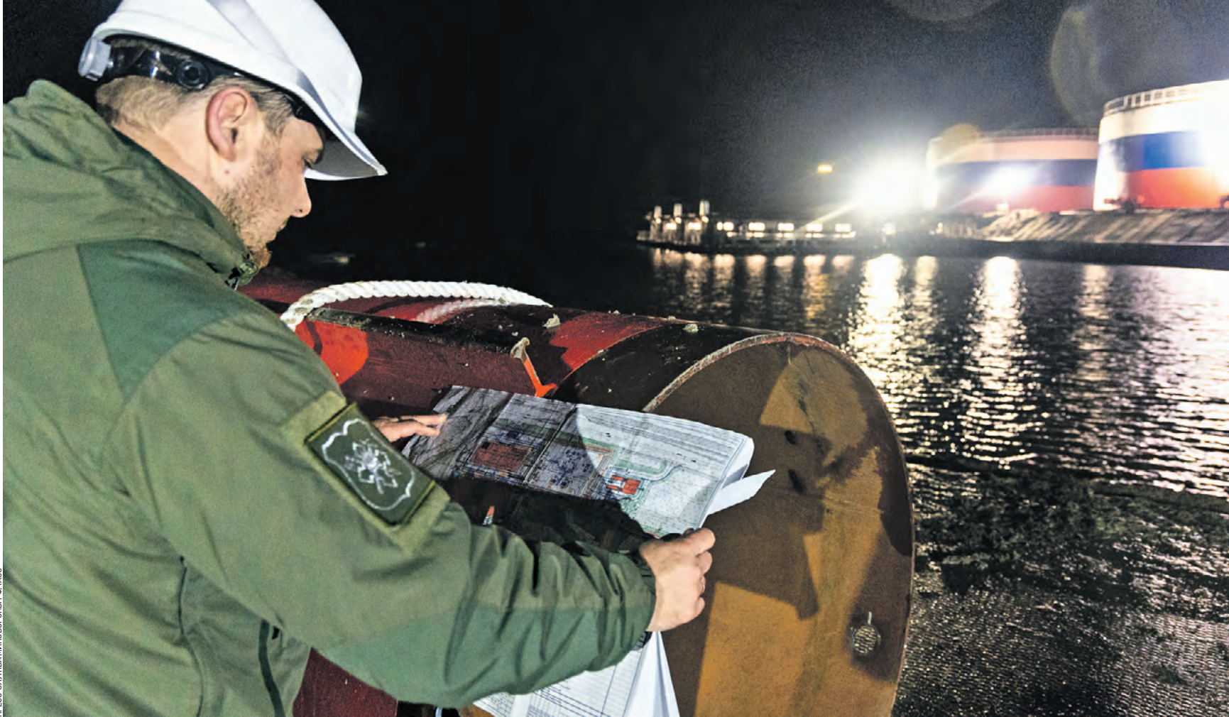
29 марта 2023 года. Специалист проверяет работу одной из насосных станций, которая вошла в состав водовода «Дон — Донецк»
