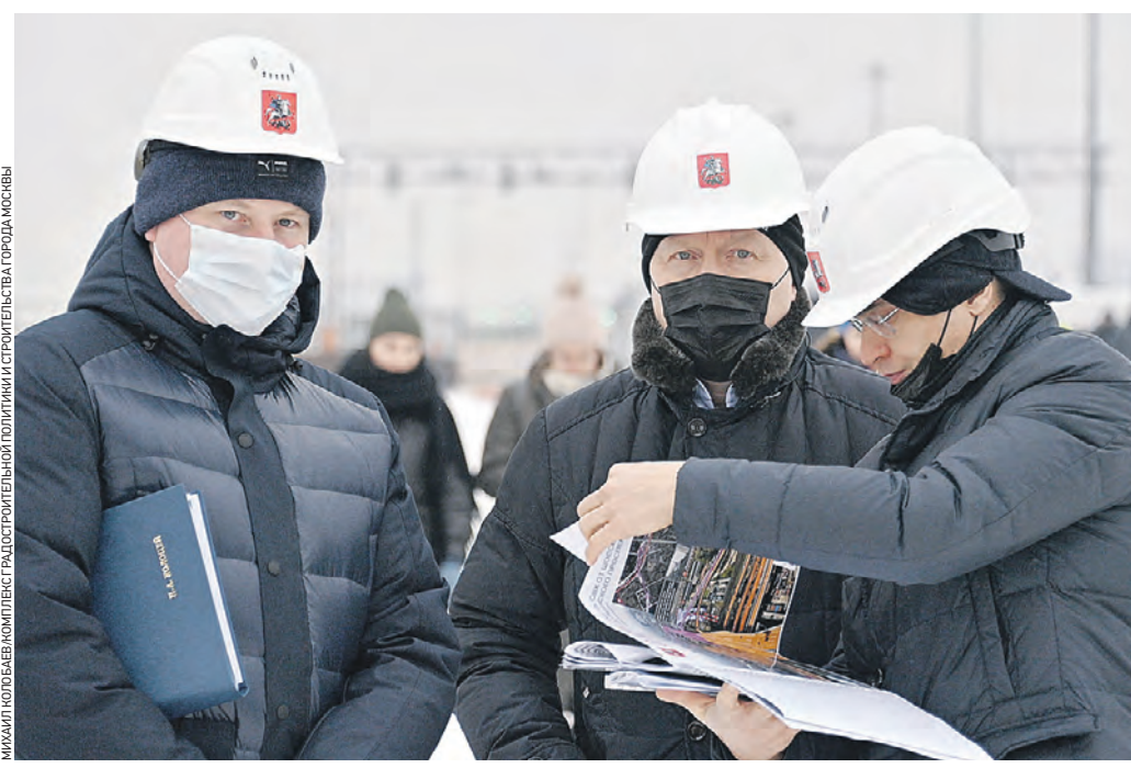
24 января 12:50 Ход сооружения скоростного диаметра проинспектировали заммэра Андрей Бочкарев (в центре), глава Департамента строительства Рафик Загрудинов (справа) и директор ГКУ «УДМС» Николай Колодцев
