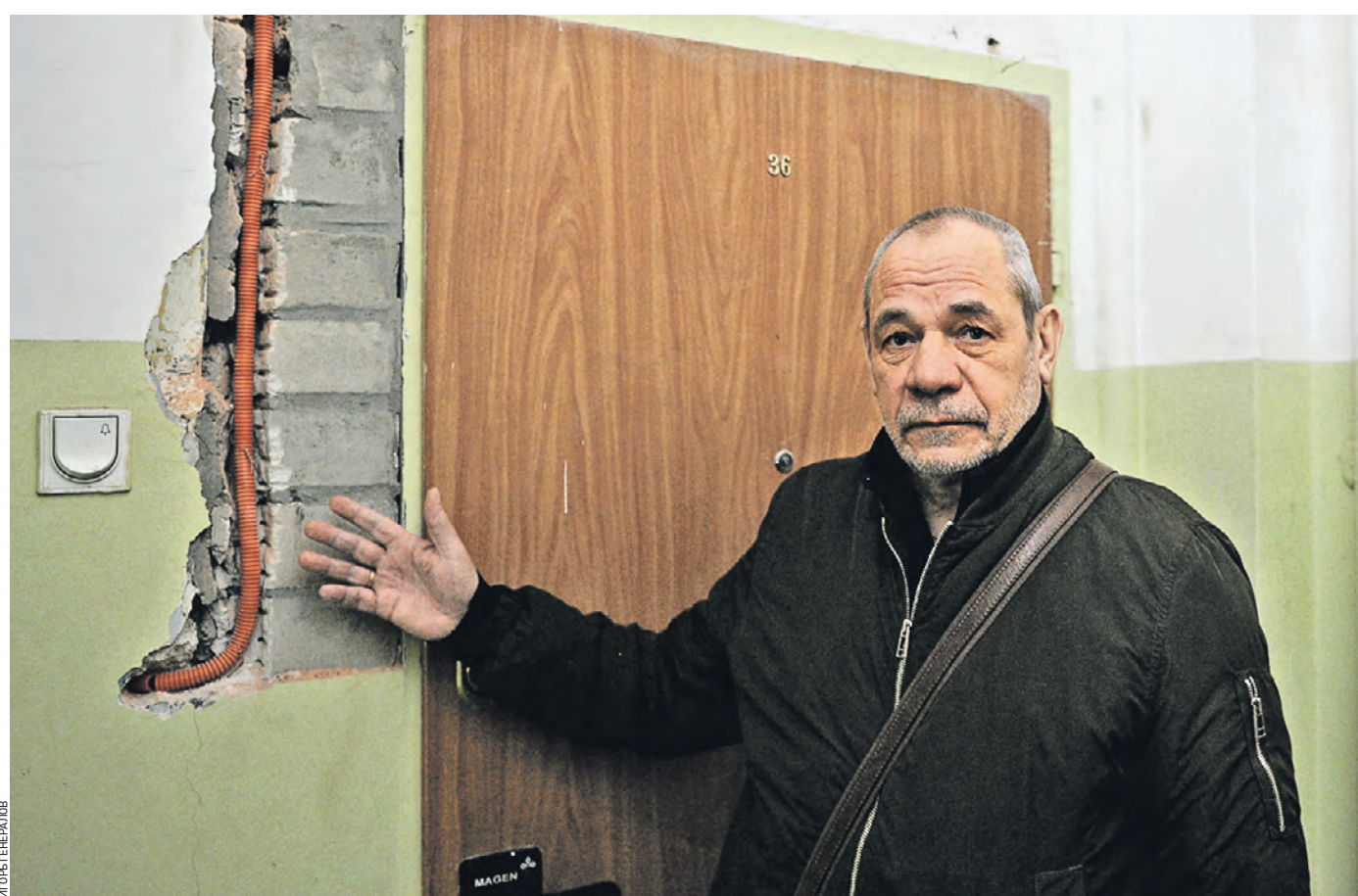
18 марта 08:35 Житель дома № 13 по Малой Бронной Игорь Сорокин показывает кабельные каналы, сделанные в стенах подъезда во время ремонта. Бригада оставила провода на виду, так и не завершив работу
