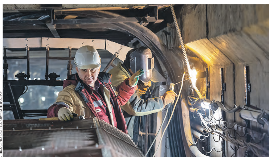
31 октября 13:40 Электромонтажник Арнадий Муругов (слева) проводит проверку тоннелей на участке от «Каховской» до «Зюзино» Большого кольца метро
