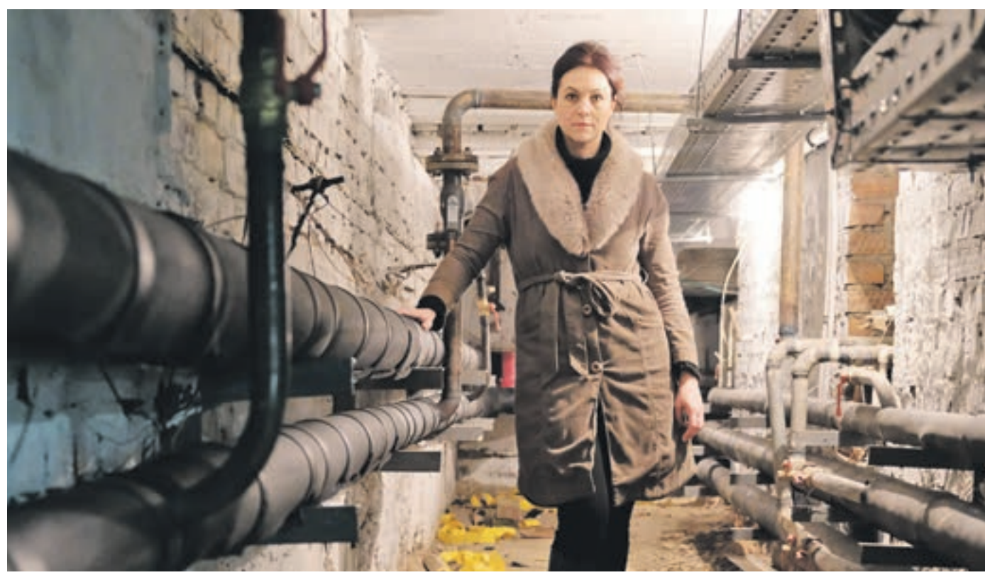
16 ноября 2017 года. Председатель совета дома № 3/13 по улице Дурова Дарья Хмельницкая. Чтобы не остаться с дырявыми трубами, жильцы сами вынуждены inspectировать тепловые пункты
