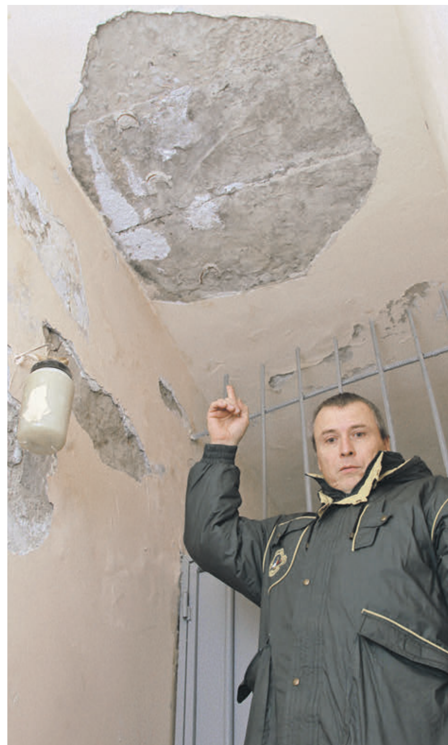
29 октября 10:15 Рустам Гайнулин показывает, что из-за протечек с чердака в подъезде дома облупилась краска и требуется очередной ремонт
