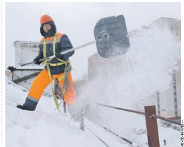
Вчера 12:30 Кровельщик Георгий Антонов сбрасывает снег со ската крыши дома № 13 по Новоросийской улице
