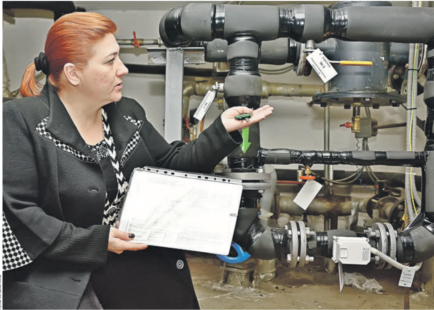
24 октября 2018 года. Председатель ЖСК «Топограф» Наталья Дрожжева показывает, как выглядит установка автоматической системы управления теплоснабжением
