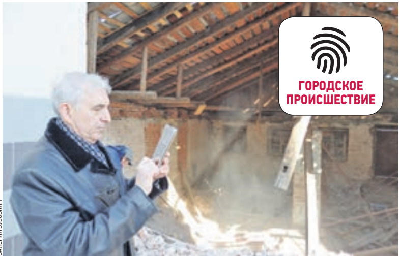
Вчера 08:47 Директор ГБУ «Жилищник» Басманного района» Юрий Плоскин делает пометки, осматривая полуразрушенное здание
