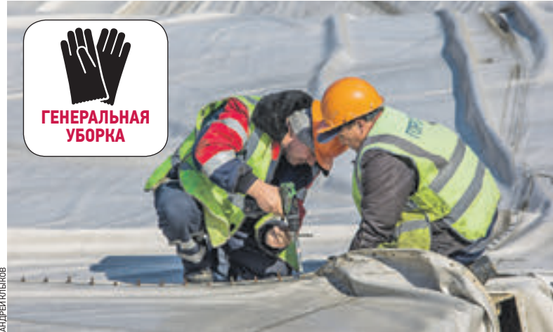
Вчера 11:40 Работники ГБУ «Гормост» разбирают воздушный купол, который укрывал музыкальный фонтан на протяжении долгой зимы
