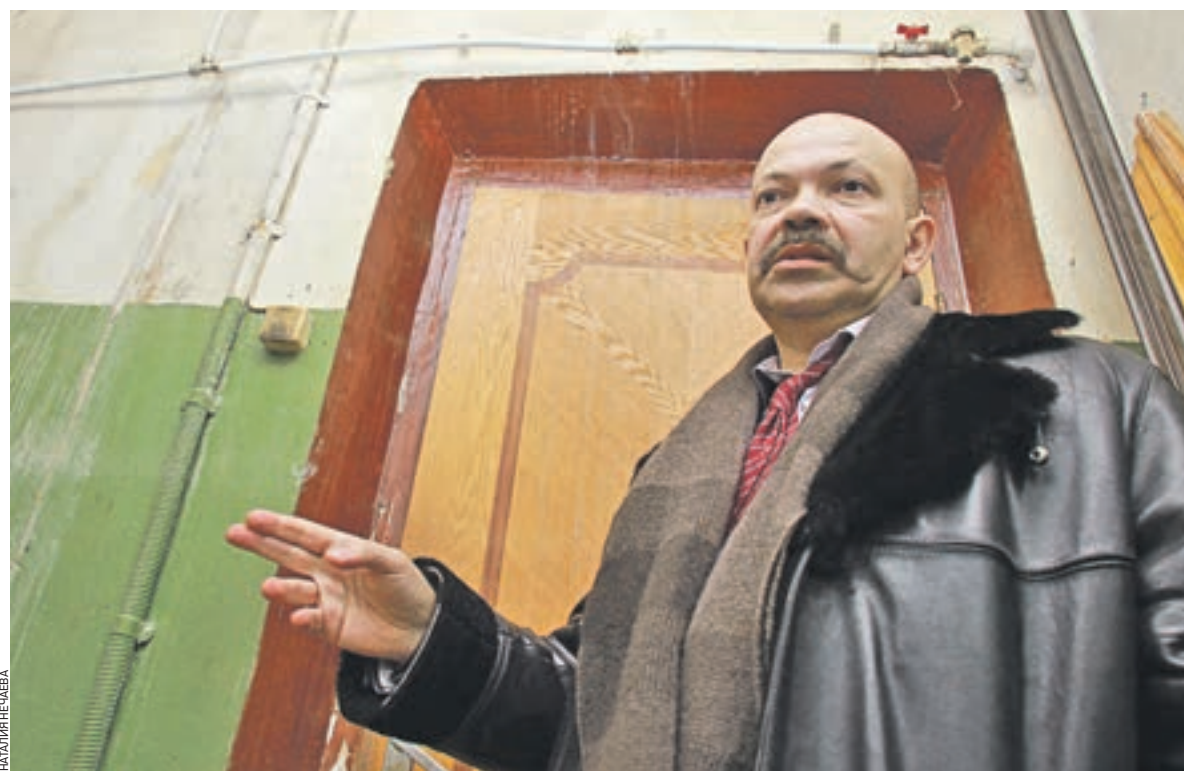
23 ноября 2016 года 17:15 Москвич Сергей Максимов пожаловался на отсутствие в доме на 2-й Брестской улице горячей воды. В ходе капитального ремонта установка горячего водоснабжения в здании не предусмотрена
