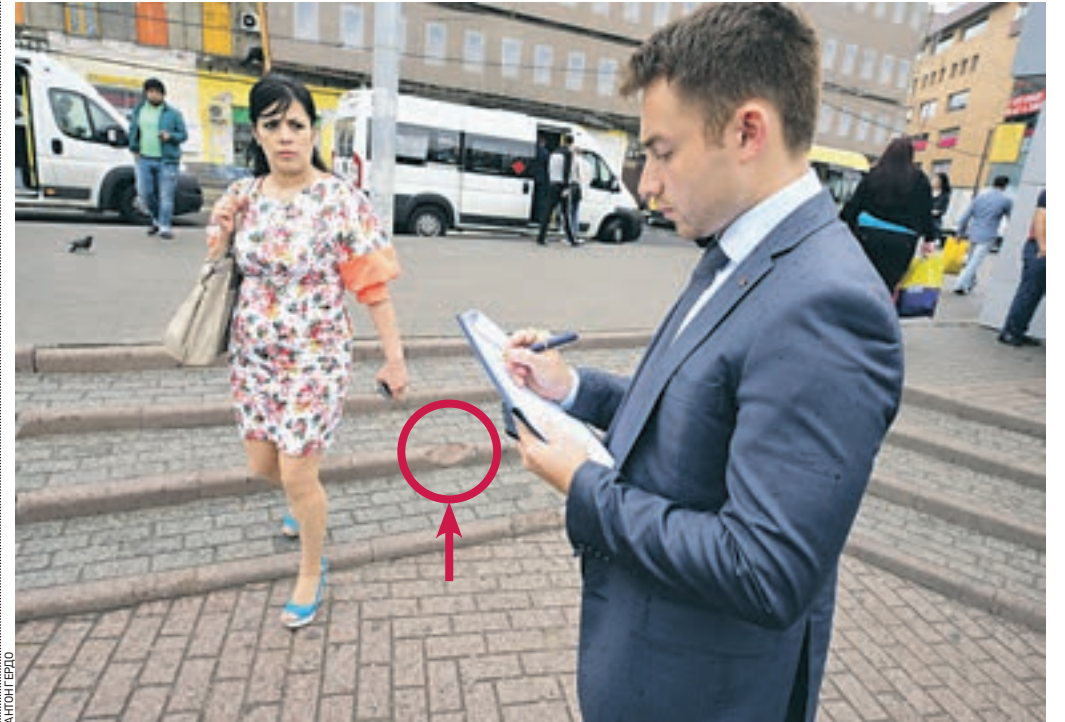
Вчера 11:12 У входа на станцию «Марксистская». Главный инспектор Дорожной инспекции ОАТИ Евгений Анпилов фиксирует нарушение: здесь начали крошиться бордюры
