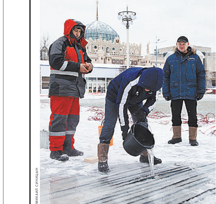
Покрытие катка на ВДНХ готово на 90 процентов. Осталось нарастить последние и самые важные слои льда.
