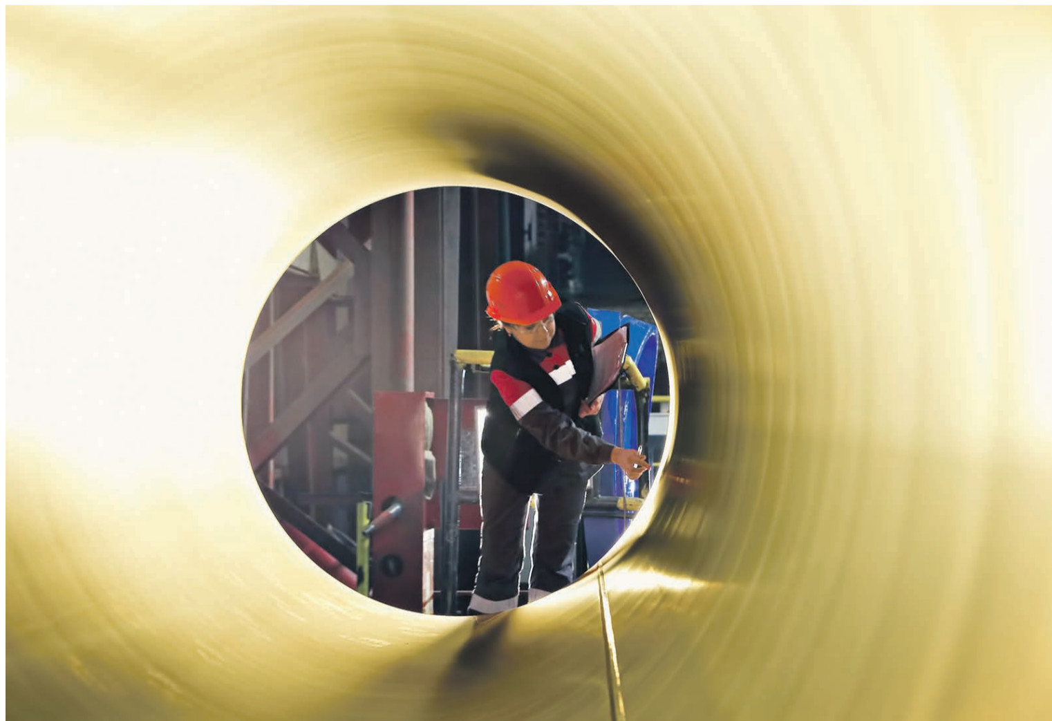
«Стройгазконсалтинг» ищет способ не вылететь в трубу
