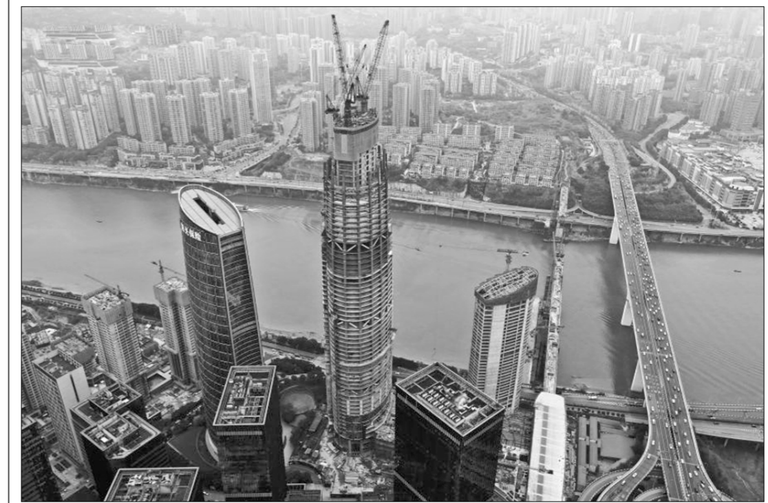
Строители компании China Construction Third Engineering Bureau, возводящие 458-метровую башню в рамках второй-третьей очереди квартала небоскрёбов в микрорайоне Хуацунь города Чунцин (Юго-Западный Китай), на днях преодолели 300-метровую отметку. Квартал небоскрёбов станет местом компактного расположения городского комплекса высотных торгово-офисных зданий.
