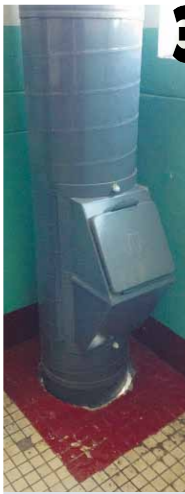
Во многих домах за деньги жильцов недавно заменили мусоропроводы. И что, их теперь и заваривать за деньги жильцов?
