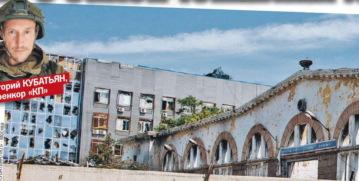
Здание спасательной службы после обстрелов - половина окон выбиты, вместо гаража - бетонный скелет...
