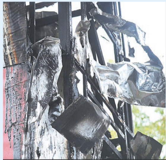
К моменту приезда пожарных полыхали обшивка и фасад.
