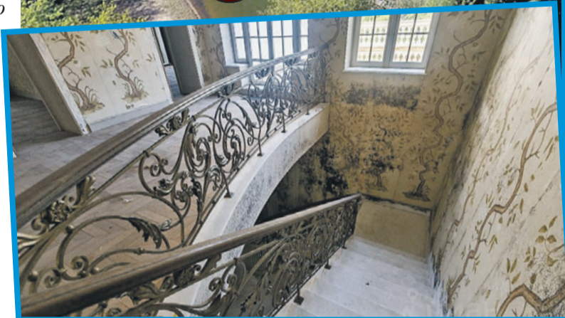
...но из-за ошибок при строительстве главный дом изнутри покрылся жуткой плесенью.
