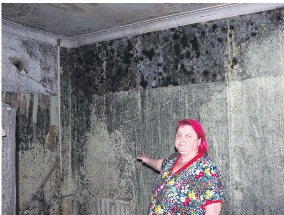
В комнате отрезано отопление, но из трубы на чердаке вода текла всю зиму.
