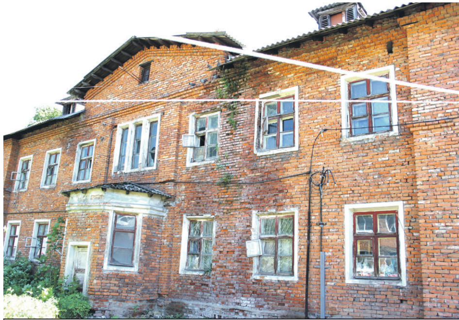
Фасад покрыт трещинами и плесенью в местах протечек.
