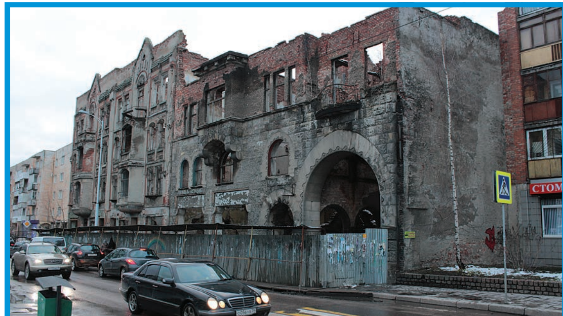
Еще несколько лет назад Кройц-аптека на улице Фрунзе была самой известной руиной Калининграда.
