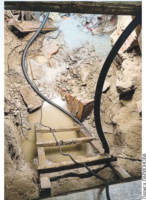
Так выглядит подвал дома на улице Кирова в Новосибирске.
