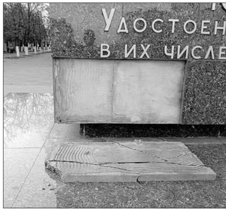
Гранитная плитка на мемориале постоянно отваливается.
