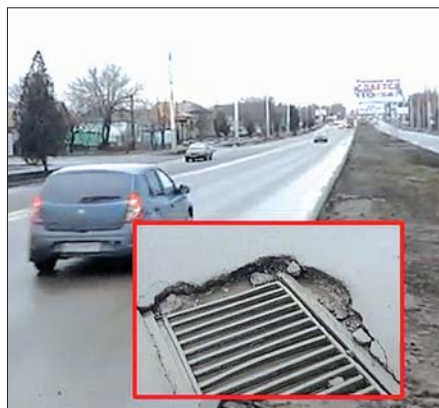
Новая дорога на улице Маяковского начинает разрушаться.
