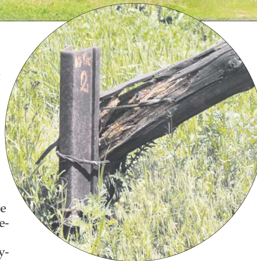
Столб сгнил и разрушился у основания.
