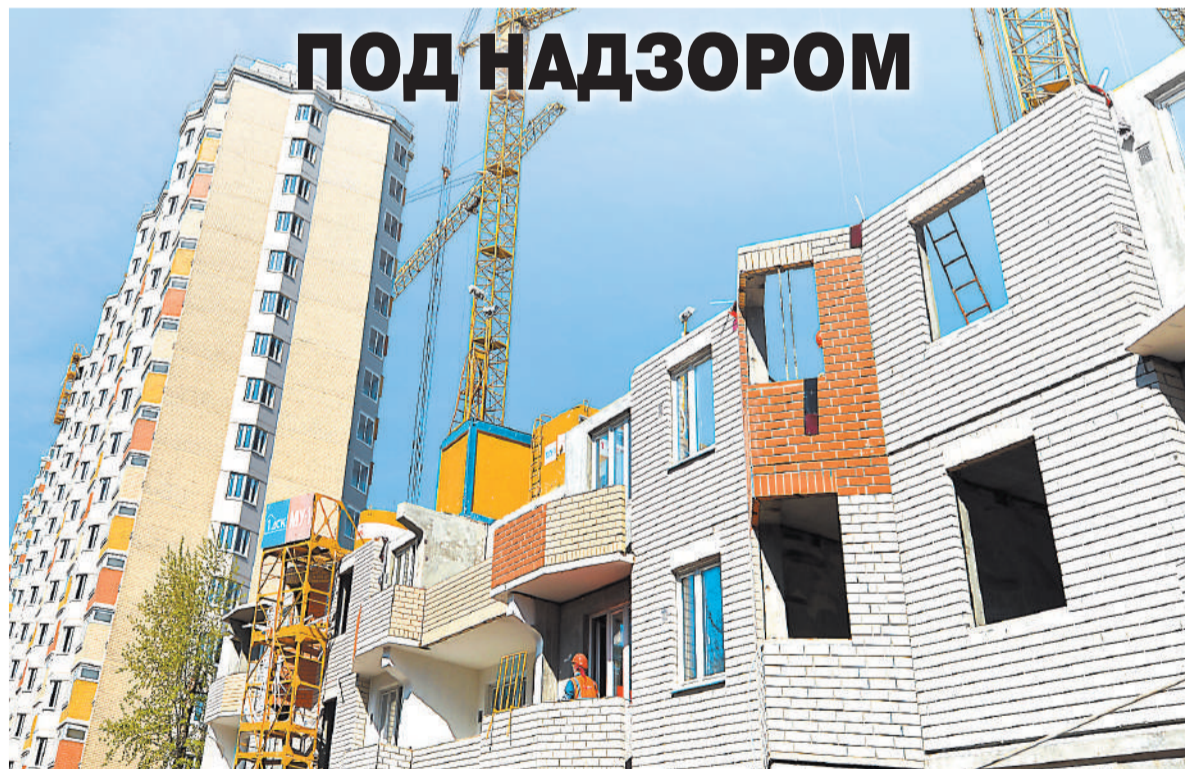
За прошедшие полгода проверили 25 жилых домов, наиболее частые нарушения - отслоение обоев и неровность укладки плитки.
